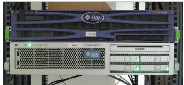
Abb 4: Sun Fire T2000 1 GHz, SWD-Server am ZID, darüber Sun Fire V240
